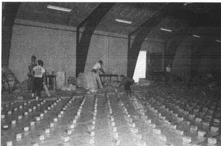
Det er et stort arbejde at lave et gulv, der kan fjedre
