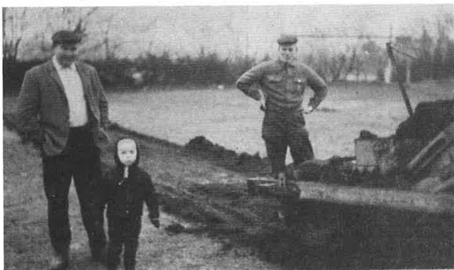
Opstart af udgravning til Sunds Hallen. Keld Bertelsen, hans søn Allan og Ove Jensen ser på
